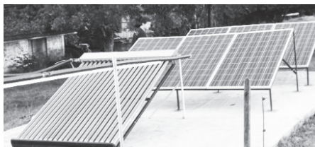
Figura 1. Sistema de co-geração instalado.
